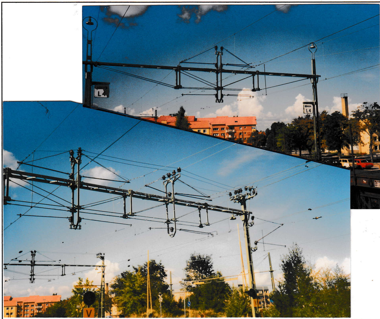
Fig 2.10 Ledningsbryggor med olika utriggare och matning från en lastspårsavskiljare
