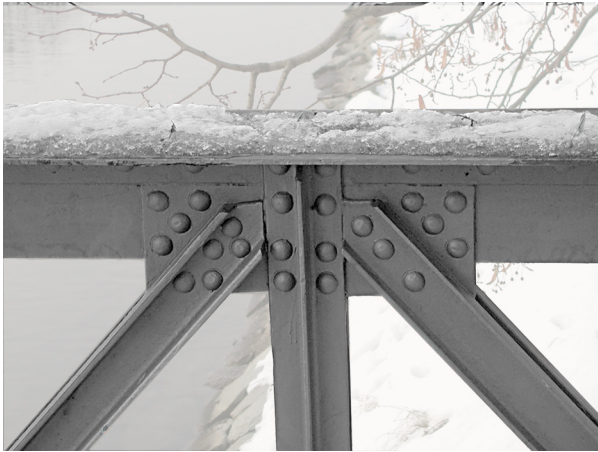
Utformning av knutpunkt på lättare svängbro. Bron över Djurgårdsbrunnskanalen, Stockholm. Foto L-G Fredriksson, 2004
