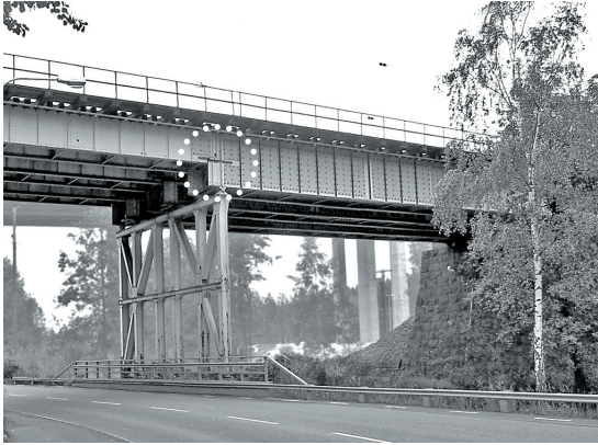
Balkbroar i Södertälje hamn 2004. Brokonstruktionen består av två balkbroar. Högra huvudbalken är väsentligt högre genom att spännvidden är ungefär 1,5 gånger längre än den vänstra. Notera att den vänstra bronns upplag är en del av den högra. Gemensamt stålfackverk som mellanstöd för båda broarna.
