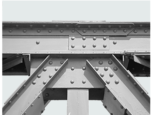
Utformning av knutpunkt på tyngre fackverkskonstruktion. Uppfartsrampen för järnvägsspår i Trelleborgs färjeterminal. 2004
